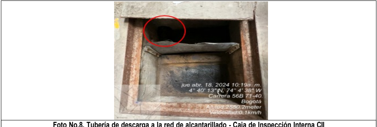
Foto No.8. Tubería de descarga a la red de alcantarillado - Caía de Inspección Interna CII
